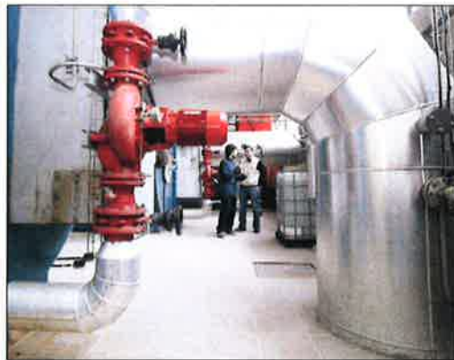
Les installations intérieures de l'actuelle chaufferie de la Côte Sainte-Catherine. Photo ER/DR
