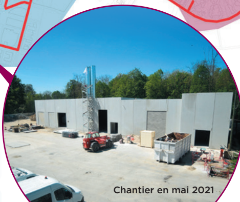
La centrale de géothermie GéoMarne
