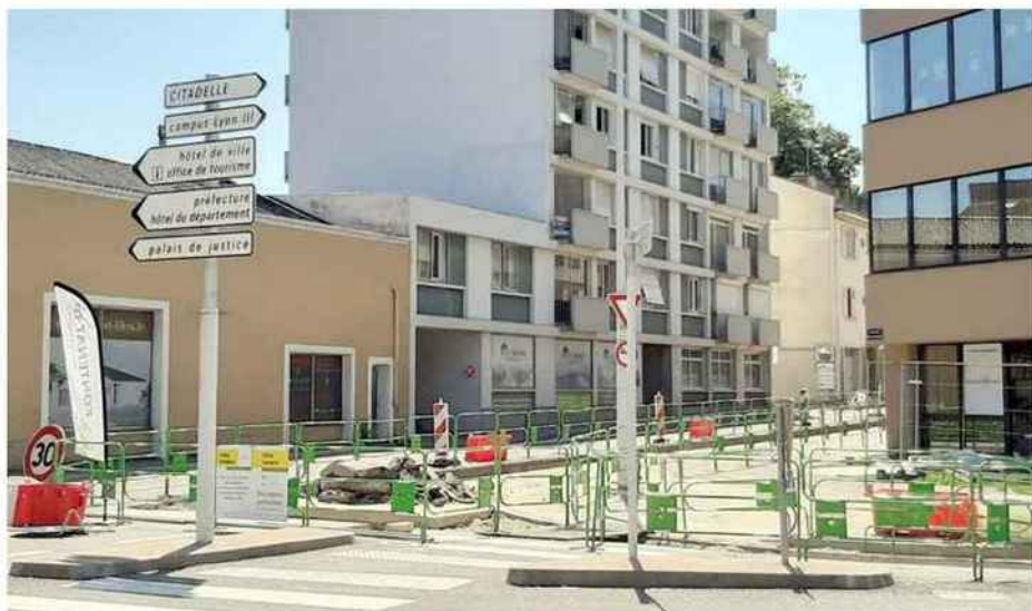
Le réseau de chaleur au départ de la chaufferie bois de la Vinaigrerie en cours d'extension jusqu' au faubourg de Mâcon et le centre universitaire Lyon II
