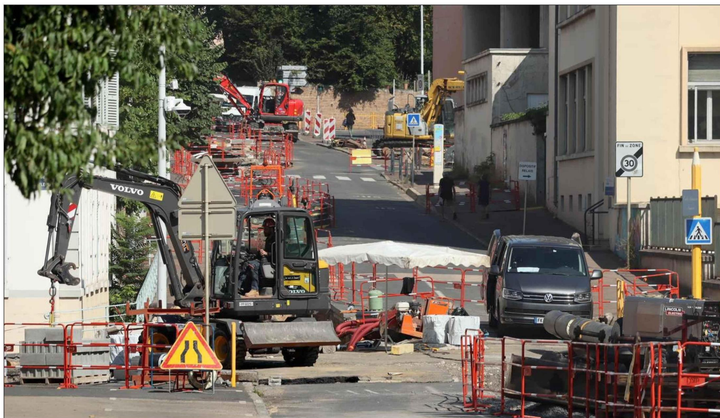
Après trois mois de travaux, le chantier de la rue de l'Héritan est sur le point de s'achever. La rue sera rouverte à la circulation mercredi 31 août. Photo JSL/Fernand RIBEIRO
