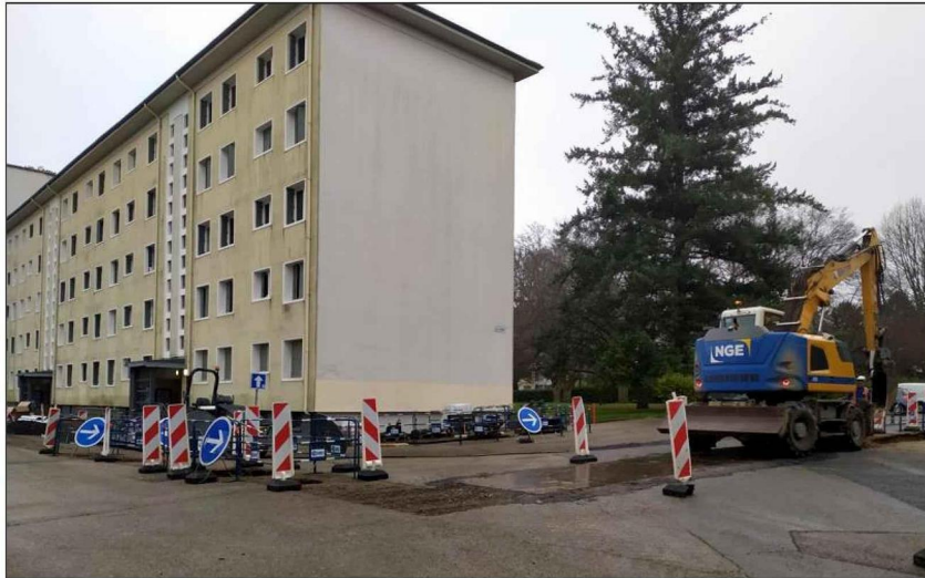
La chaleur émise par l'unité de traitement des déchets va chauffer 482 logements de la Roue. Photo Progrès/Jean-Michel PERRIER
